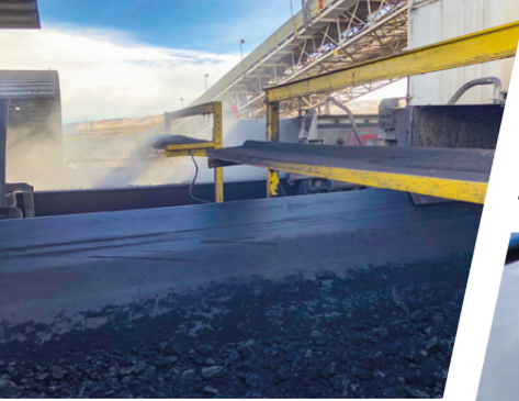
STEINERT Metal Dedektörü kömür yıkama tesisinde
